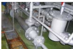
排熱回収装置
