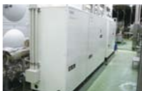
ヒートポンプ機
